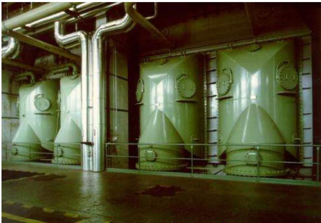
Napájecí čerpadla VVER-440 (zdroj ČEZ a.s.)
